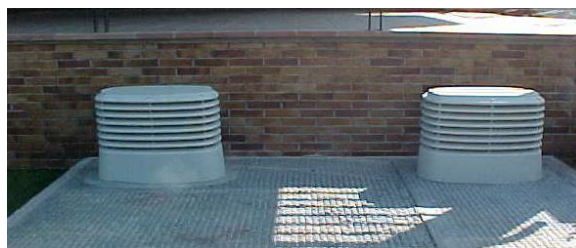
Figura 3.18: Ventilación y acceso a CT subterráneo.
