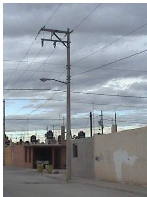
Figura 3.23: Red aérea de distribución de Baja Tensión.
