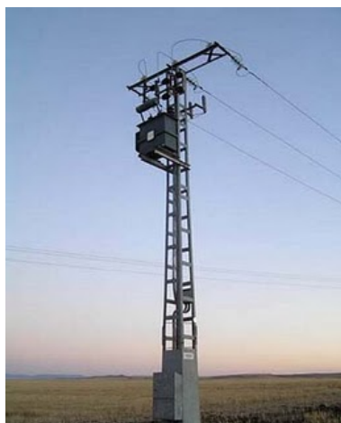
Figura 3.13: Centro de transformación a intemperie.
