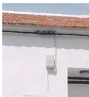
Figura 4.8: CGP en fachada con acometida aérea.
