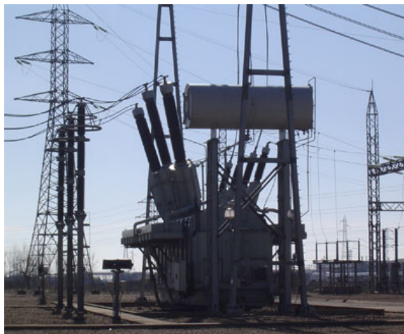
Figura 3.9: Subestación Elevadora de Tensión.
